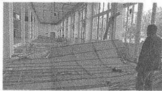
I controsoffitti crollati nel 2011
